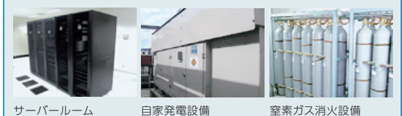
サーバールーム 自家発電設備 窒素ガス消火設備
